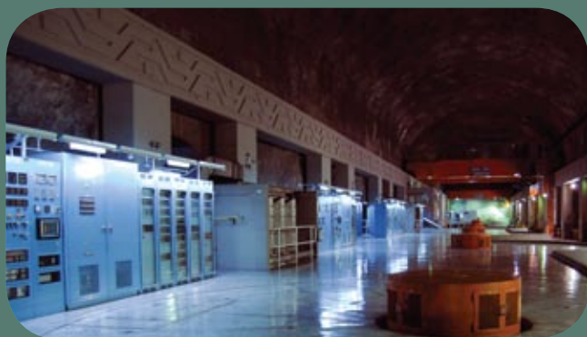
● Planta generadora de energía
