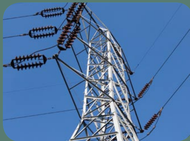
● Detalle torre de energía
